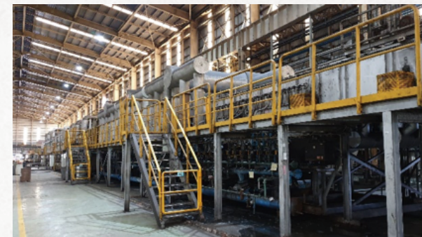
退火爐防墜欄杆
